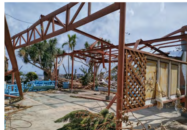
Destruição causada pelo furacão que assolou as Filipinas.
